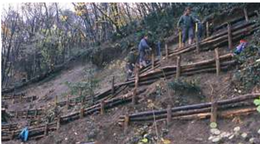
Mouvement de terrain : les paliers de stabilisation du terrain installés à la Frange verte par L'ONF.
