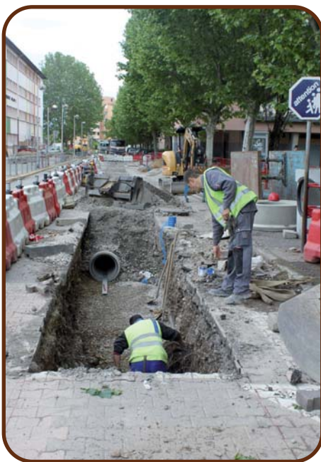
192 logements réhabilités, ainsi qu'une trentaine de logements neufs, sont déjà raccordés au chauffage urbain. 268 le seront en 2011 et les 182 derniers en 2012.
